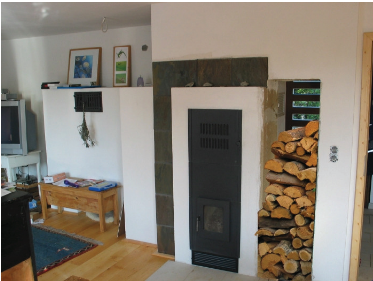
Zentrale im Erdgeschoß: Der Ofen mit angeschlossener Speicherwand. Er bildet mit einer Solaranlage und einem großen Schichtenspeicher die Zentralheizung des Hauses.
