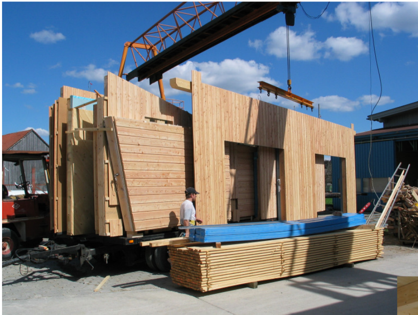
2 Tage vor der Montage: HolzBauHaus-Mitarbeiter verladen das Haus auf das flexible Transportsystem
